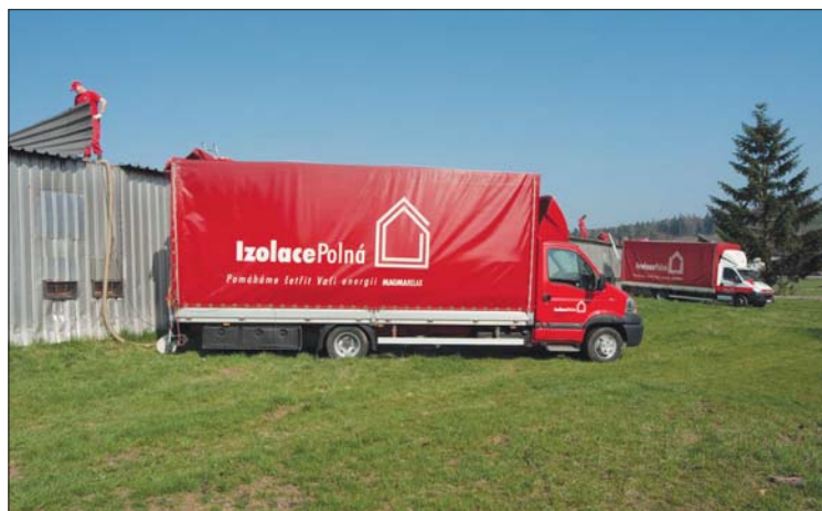
Nákladní vůz IP Polná, z kterého je izolace poháněna
