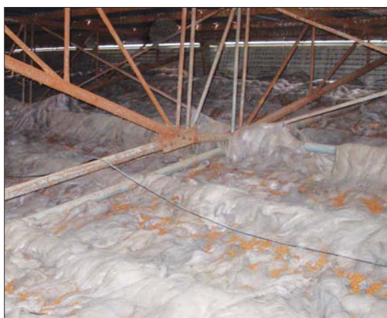
Stará zničená izolace
