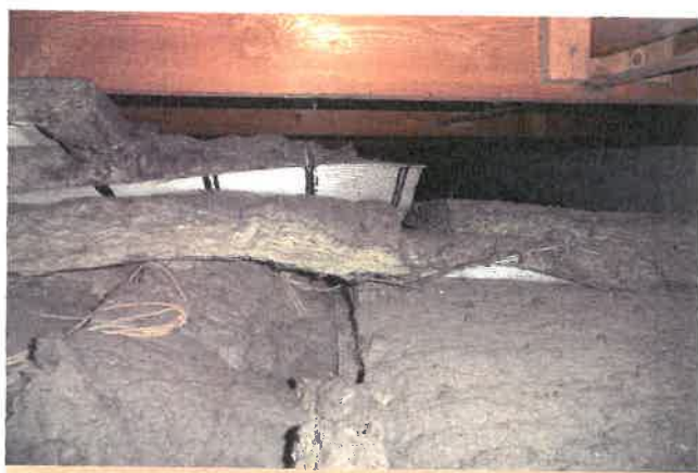
Stará poškozená izolace
